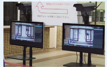
第二講義棟1階に設置してあるサーマルカメラ
